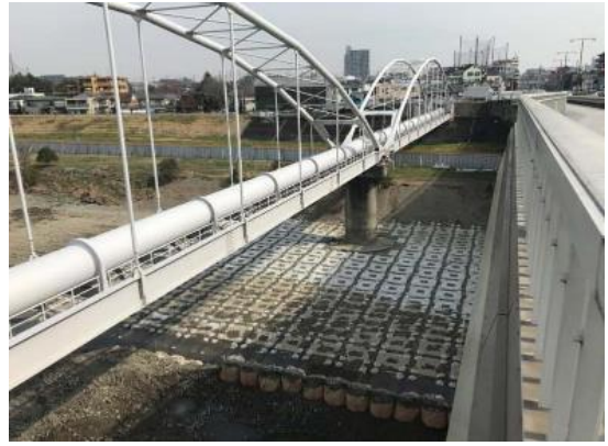
東京都調布市 多摩川 (多摩川原水道橋) セッカブロック C形3t型・半割3t型
